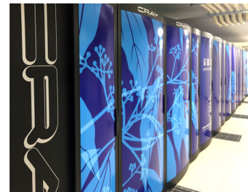
図 1: 超並列計算が可能な高性能スーパーコンピュータ。
