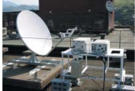
図2．屋外ユニットの概観
